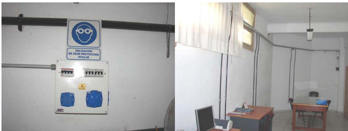
Figura 7: Instalación eléctrica realizada en el taller de Tratamiento térmicos con sus correspondientes tableros individuales y zona de oficinas.
