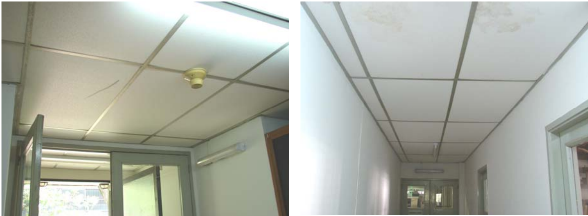
Figura 1: Nuevos cielorrasos en el área de oficinas y pasillos del Laboratorio de Máquinas Térmicas.
