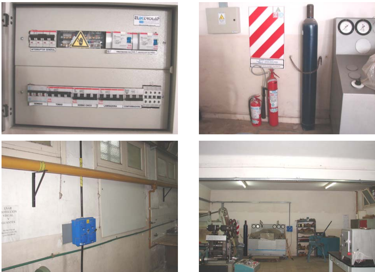
Figura 4: Nuevo tablero eléctrico e instalaciones eléctricas sobre bandejas ubicado en el taller de plasticidad del Laboratorio de Investigaciones de Metalurgia Física, con sus correspondientes llaves térmicas sectorizadas y disyuntor diferencial.
