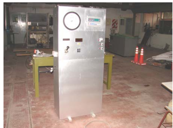
Figura 19: Vista del estado de avance de la instalación del Dinamómetro de Rodillos Zollner.
