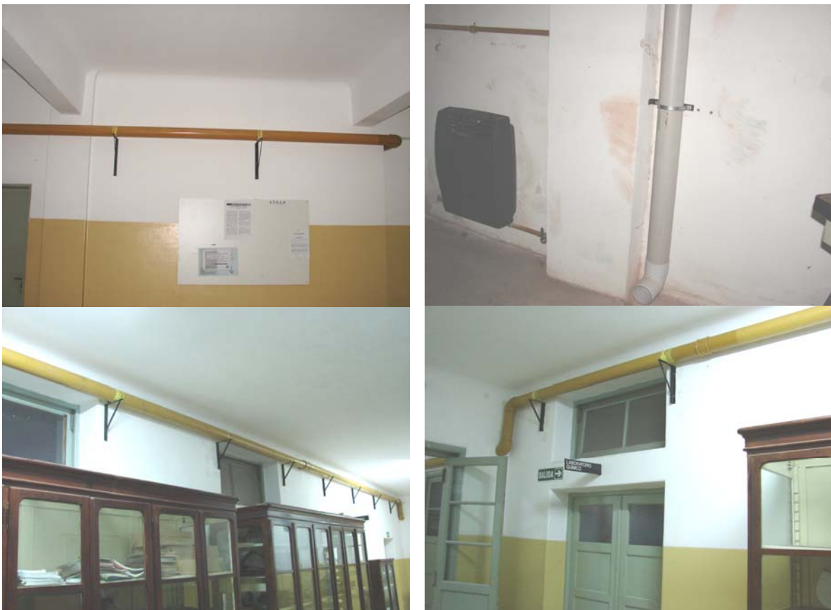
Figura 11: Vista parcial de la nueva instalación de gas en el edificio e instalación de estufas con su correspondiente ventilación.
