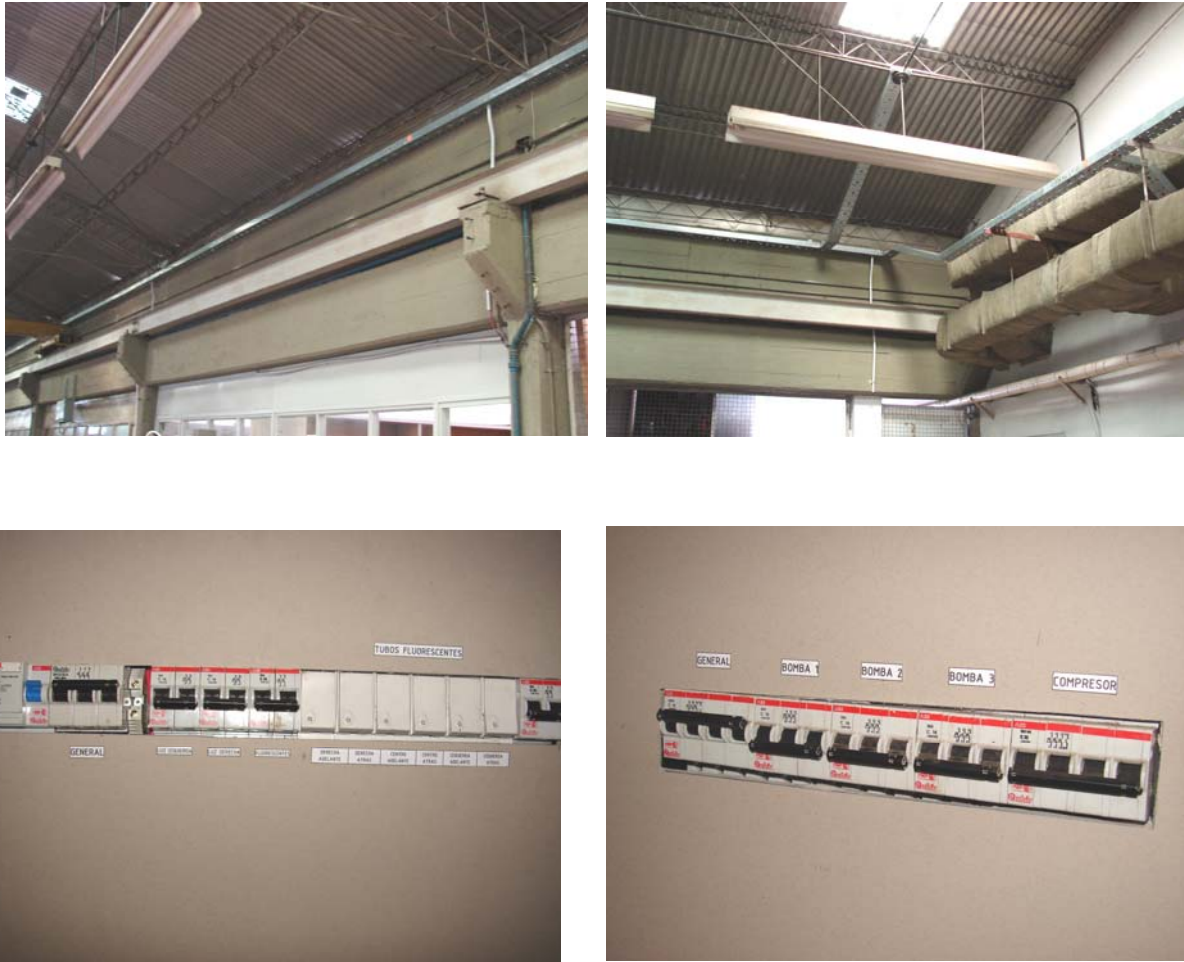
Figura3: Vista de la instalación eléctrica realizada sobre bandejas y de los tableros con sus correspondientes llaves térmicas y disyuntor en el Laboratorio de Máquinas Térmicas.
