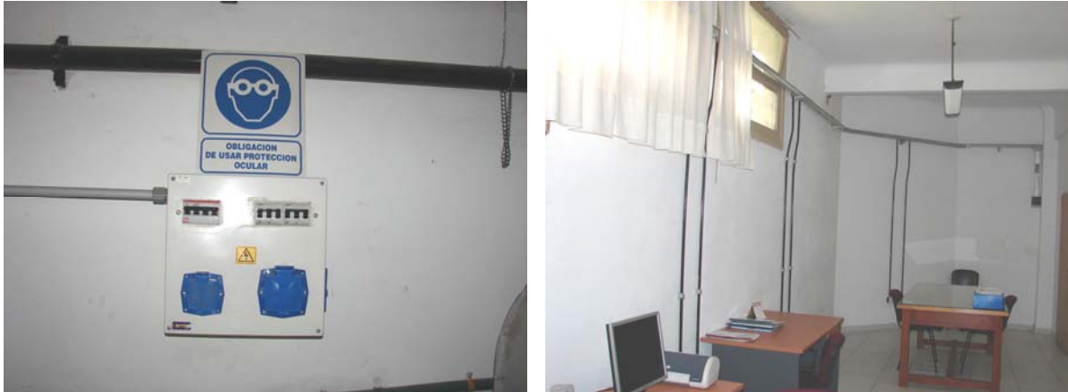
Figura 4: Instalación eléctrica realizada en el taller de Tratamiento térmicos con sus correspondientes tableros individuales y zona de oficinas.
