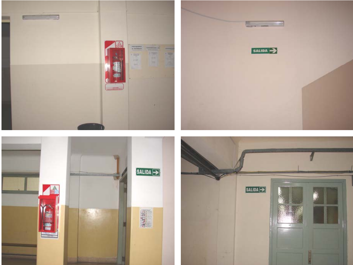
Figura 5: Diposición de las luces de emergencia, señalización y disposición de matafuegos en diferentes sectores del Área Departamental Mecánica.
