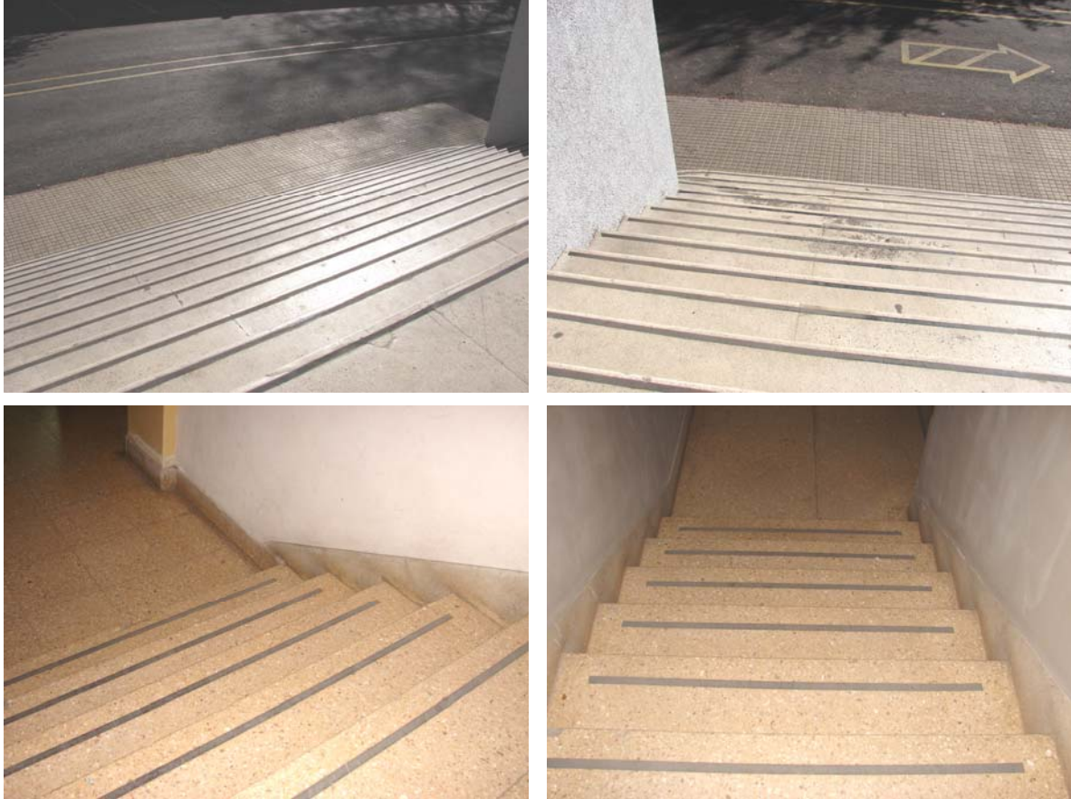
Figura 9: Vista de las bandas antideslizantes colocadas en las escaleras del edificio del Área Departamental Mecánica, vista superior escalera de la entrada principal, las inferiores de escaleras internas del edificio.
