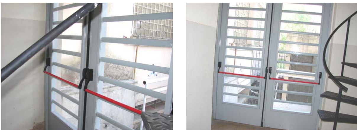
Figura 6: Salida de emergencia con puerta antipánico dispuesta en el Área Departamental Mecánica
