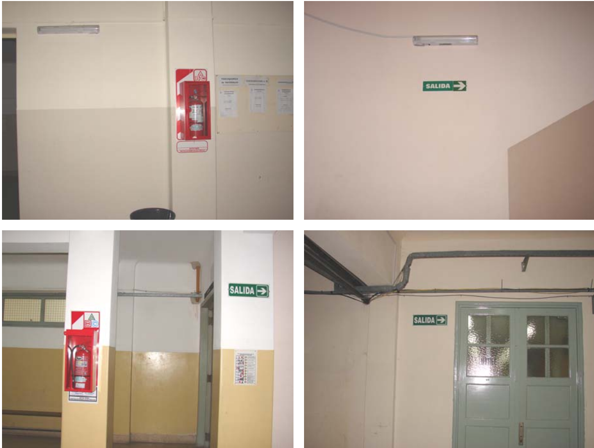
Figura 8: Disposición de las luces de emergencia y la señalización de los diferentes sectores del Área Departamental Mecánica.
