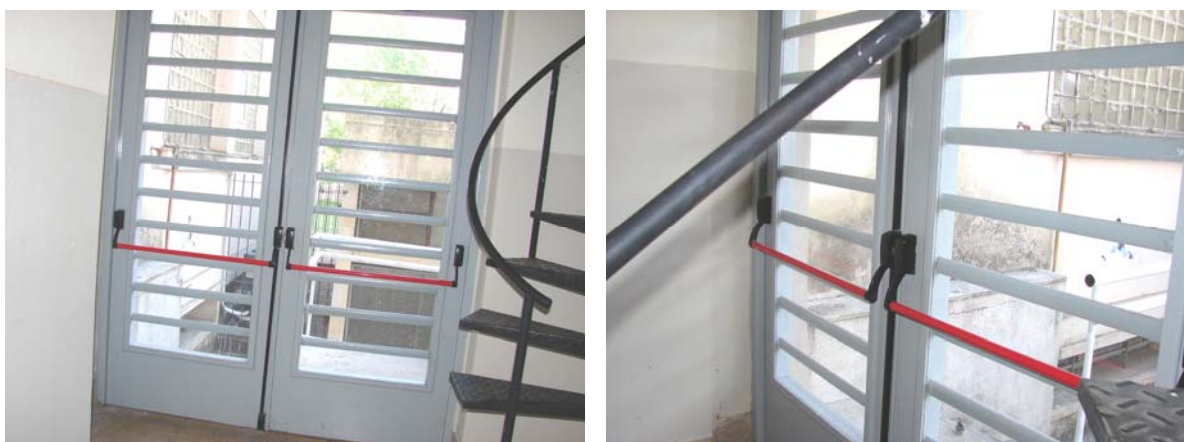
Figura 9: Salida de emergencia con puerta antipánico dispuesta en el Área departamental Mecánica
